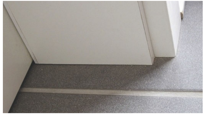
/ Die gleiche Zarge wie im Bild links auf der Schlossseite. Die Zarge ist in Waage und Lot – die Montage nicht.
